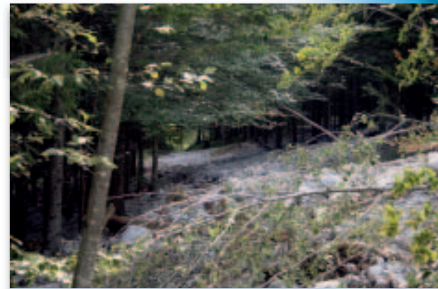
Laufende Sanierungsarbeiten sind an den Forststraßen erforderlich
