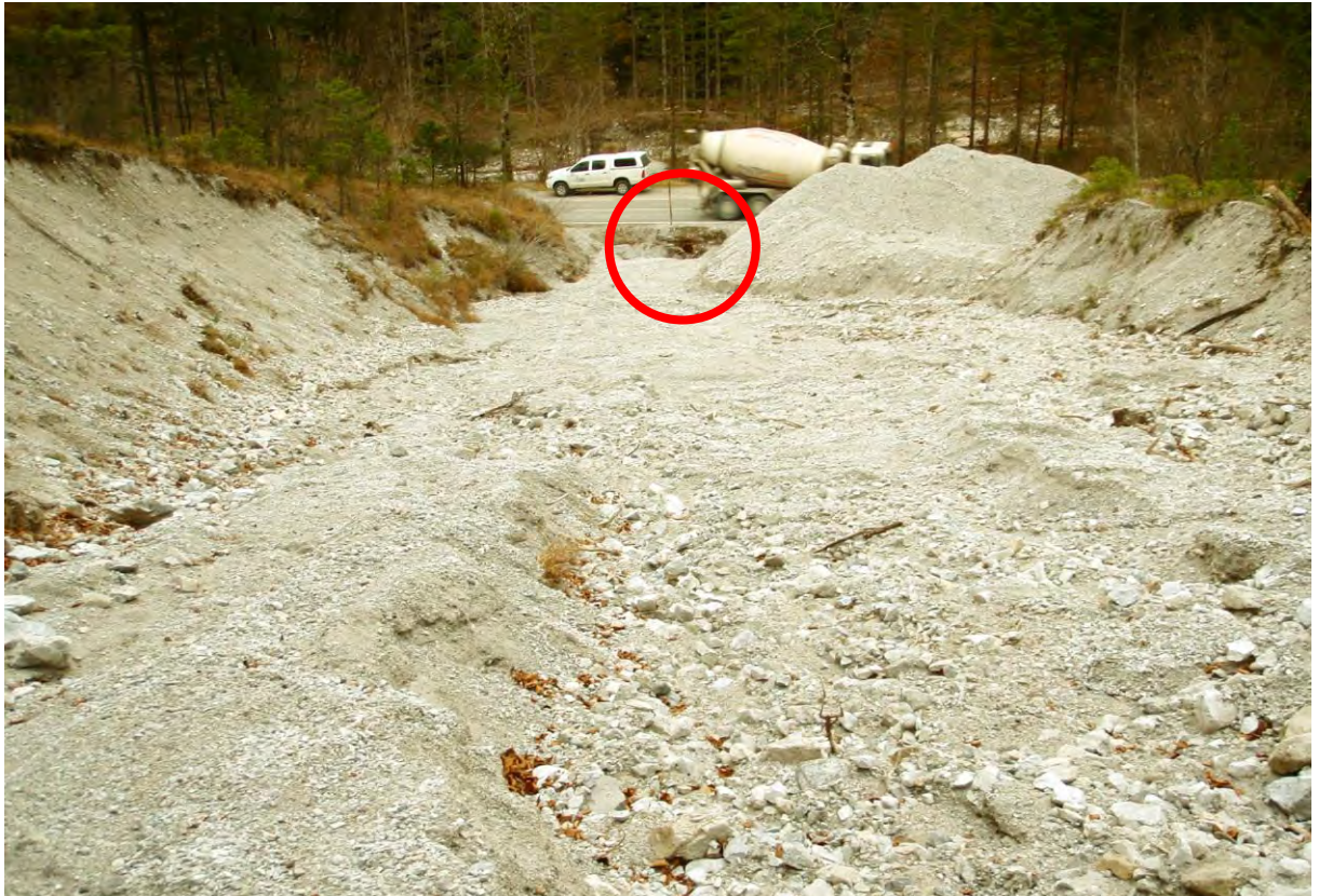
Bild 16: Neuweggraben mit Querung der Johnsbacher Landesstraße L 743 von oben gesehen. Kaum zu erkennen: Der winzige Durchlass - Foto: Haseke 23.11.2010
