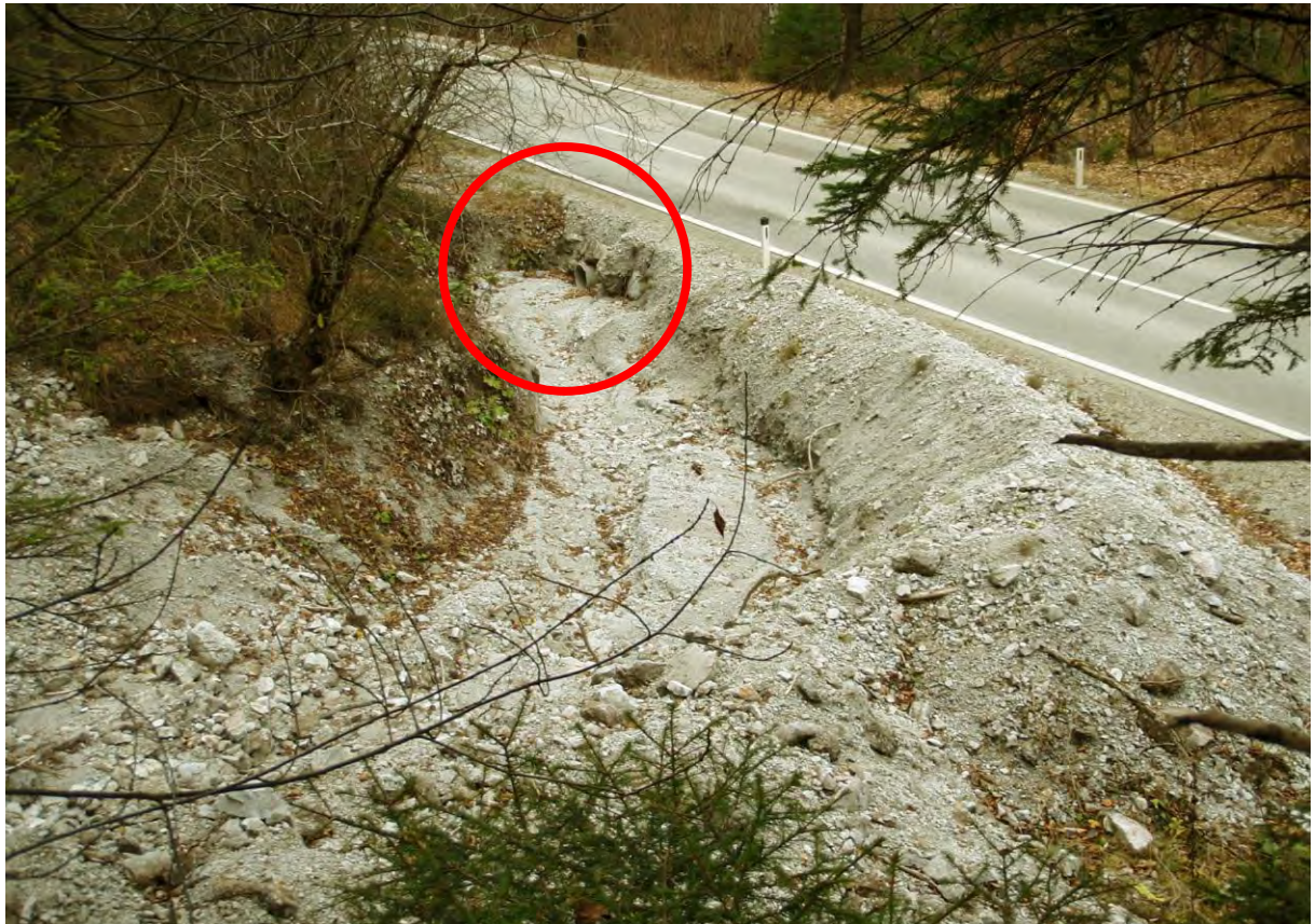
Bild 44: Fehringerkreuzgraben, völlig unzureichender Durchlass durch die L 743. – Foto: Haseke 23.11.2010
