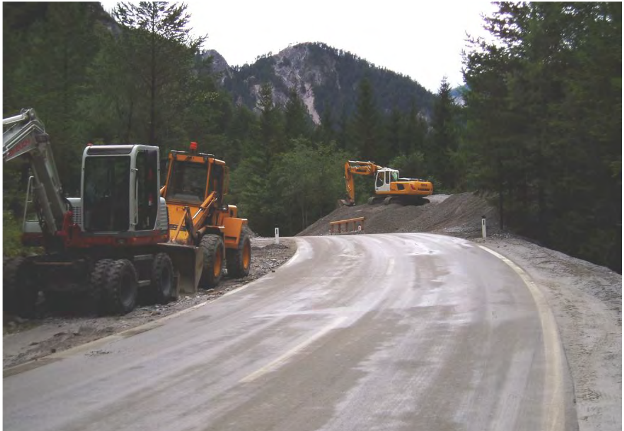
Bild 40: Buckletschneidergraben, Brücke L 743 nach dem Hochwasserereignis am 20. Juli 2008. – Foto: Haseke 23.7.2008
