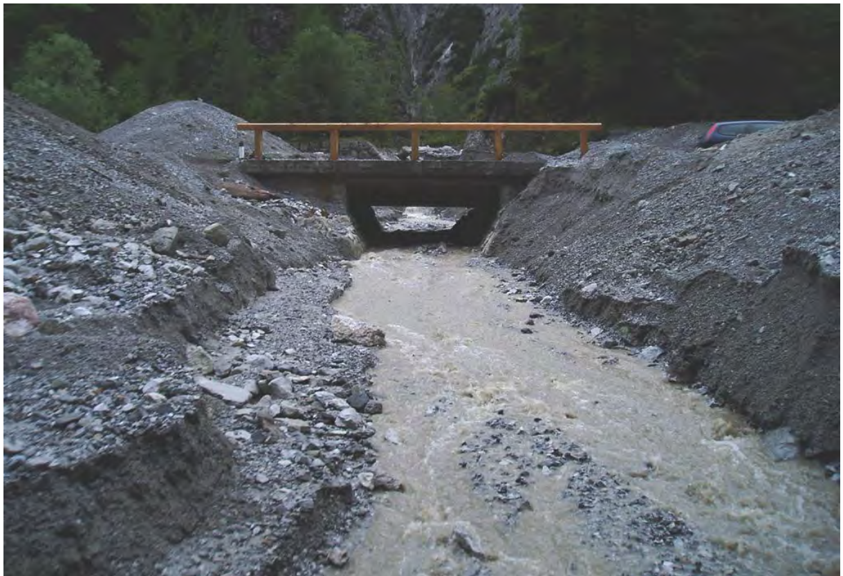
Bild 41: Buckletschneidergraben Brücke L 743 bei Hochwassersituation. – Foto: Haseke 16.8.2008
