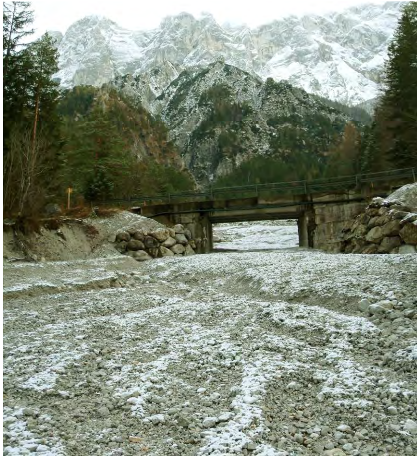
Bild 53: Haindlkargraben – Brücke der B146 von unten. Foto: Haseke 25.11.2010
