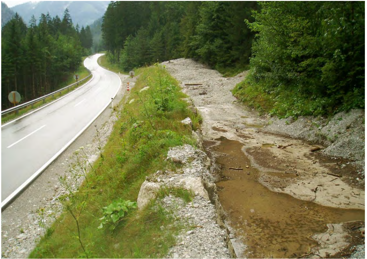
Bild 25: Murenschutzdamm an der L 743 für die vor wenigen Jahren neu entstandene "Langgriesrunse" knapp nördlich des Langgriesgrabens. Keine Verbindung zur Vorflut. - Foto: Haseke 26.7.2008
